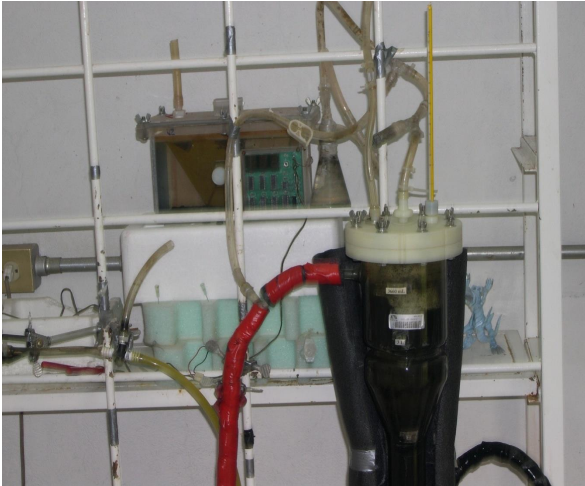
Figura 7. Medidor de biogás (Cuenta el número de desplazamientos de un volumen de biogás).
