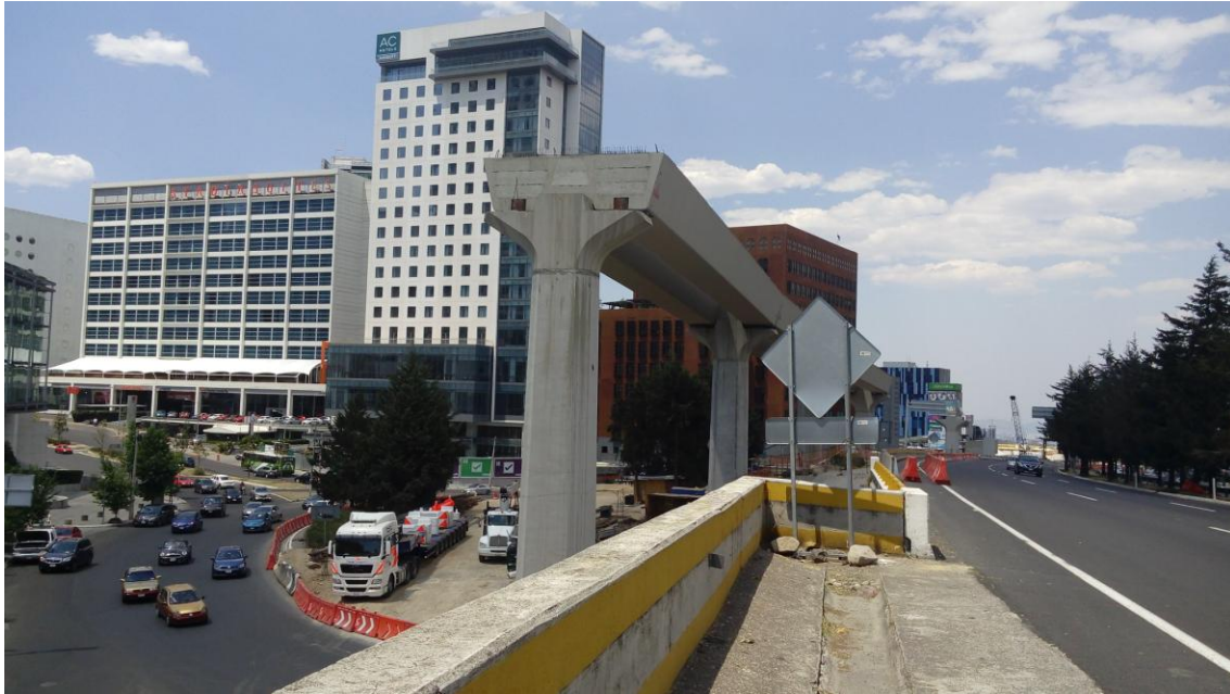
Imagen 4.4. Obras de construcción del tren interurbano de pasajeros en Santafé, en donde se prevé la construcción de una estación y recuperación de camellones. Fuente: Trabajo de Campo.
