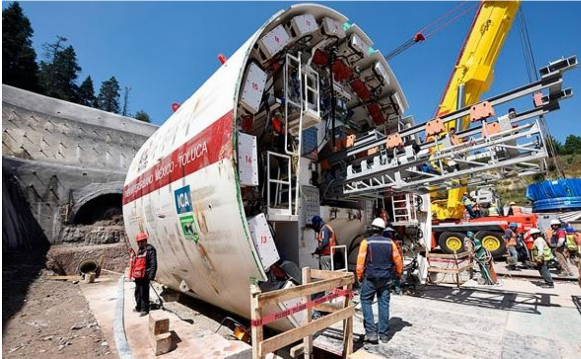
Imagen 5.10. Construcción del túnel, para evitar una parte de la Cierra de las Cruces y principal causante de los cortes de agua. Fuente: Toluca Noticias (2016).
