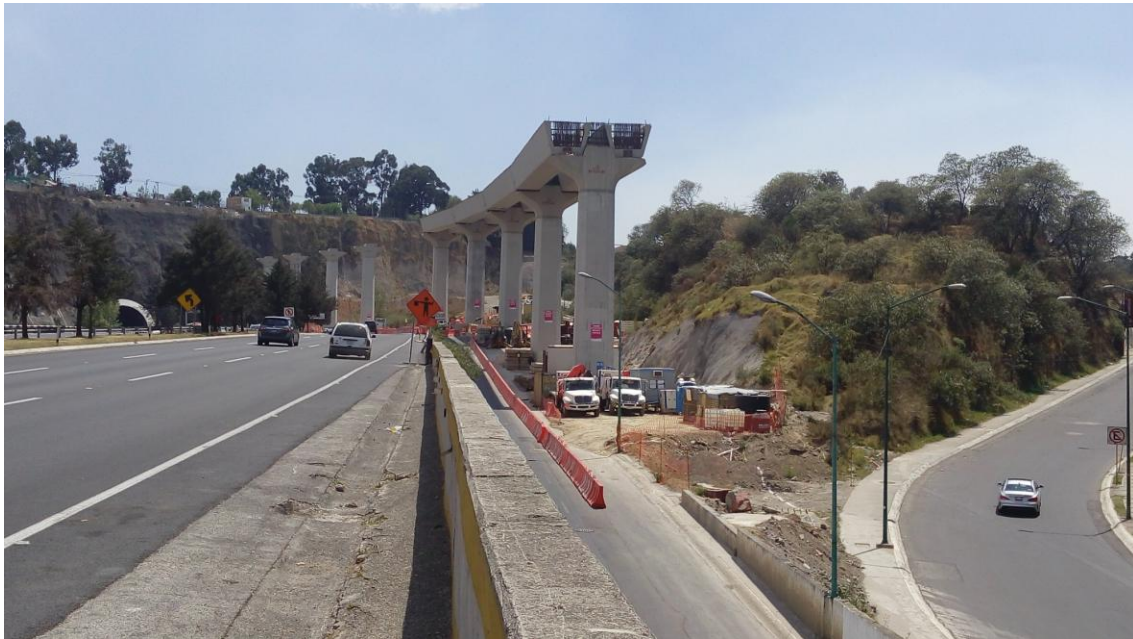
Imagen 4.1. Obras de construcción del tren interurbano de pasajeros en Santa Fe y en las inmediaciones de la carretera de cuota México-Toluca. Fuente: Trabajo de Campo.
