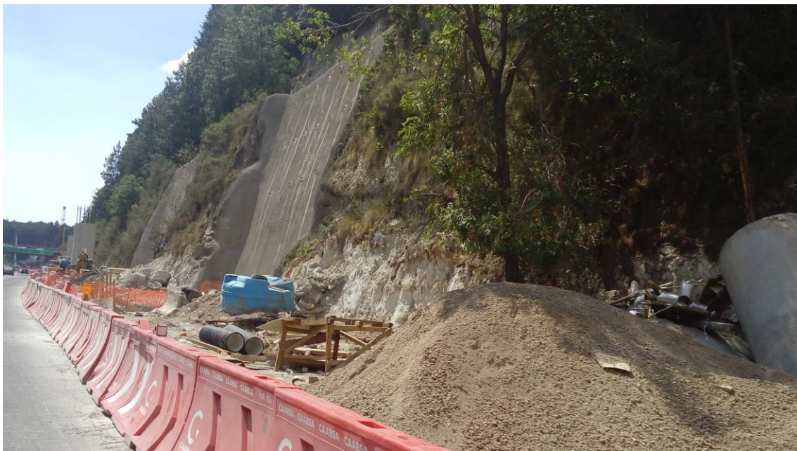
Imagen 5.4. Ejemplos de escombros derivados en la construcción, que se encuentran a lo largo del recorrido del tren, se observan plásticos tuberías, concreto maderas, varillas y acumulaciones de arena. Fuente: Trabajo de campo.
