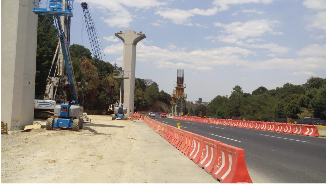
Imagen 4.2. Obras de construcción del tren interurbano de pasajeros dentro de la Cierra de las Cruces y paralelo a la carretera de cuota México-Toluca, antes de entrar al túnel por el cual evadirá una parte de la Cierra de las Cruces. Fuente: Trabajo de Campo.
