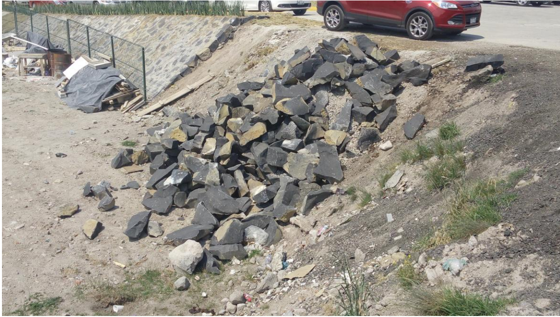
Imagen 7.6. Escombros y basura cercanos a la zona turística y derivado de fragmentar el asfalto de la carretera, para poder situar los pilares que servirán de apoyo al tren. Fuente: Trabajo de campo.
