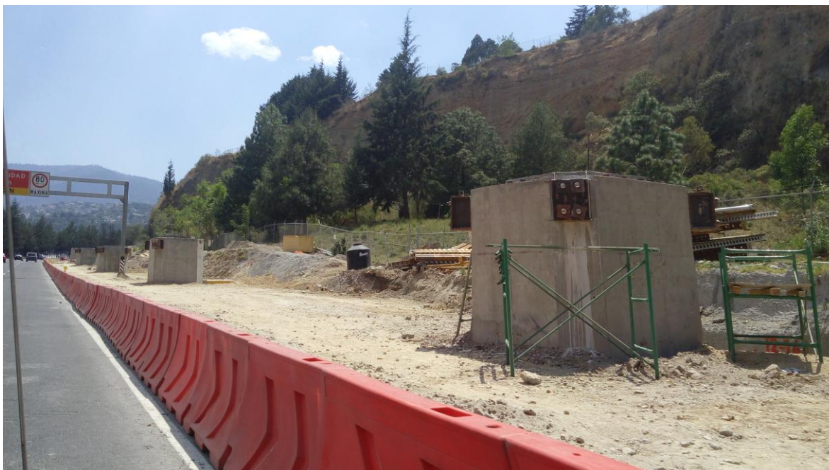
Imagen 5.8. Área en donde se han situado las bases de las estructuras de soporte del tren. Los vecinos comentan que los árboles que se encuentran en la parte trasera, están en peligro de ser talados. Fuente: Trabajo de campo.
