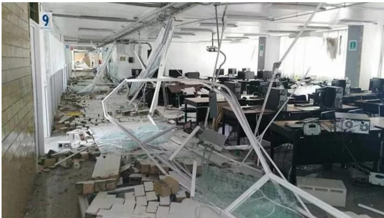
Imagen 6.3. Vista de los efectos del sismo en el departamento de cómputo de la ESCA Tepepan. Edificio "C" Fuente: Url: http://marxismo.mx/comunicado-de-la-comunidad-de-la-esca-tepepan-del-ipn/ Anónimo. s/fecha.
