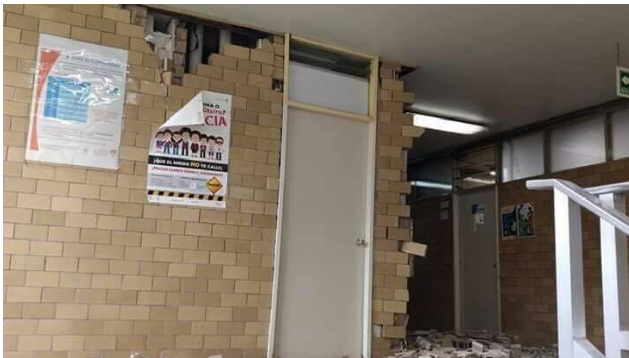
Imagen 6.4. Vista posterior al sismo de las escaleras del primer piso del Edificio "C" en ESCA Tepepan. Fuente: Anónimo. s/fecha.
