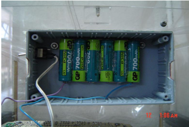
Figura 28. Banco de baterías recargables.
