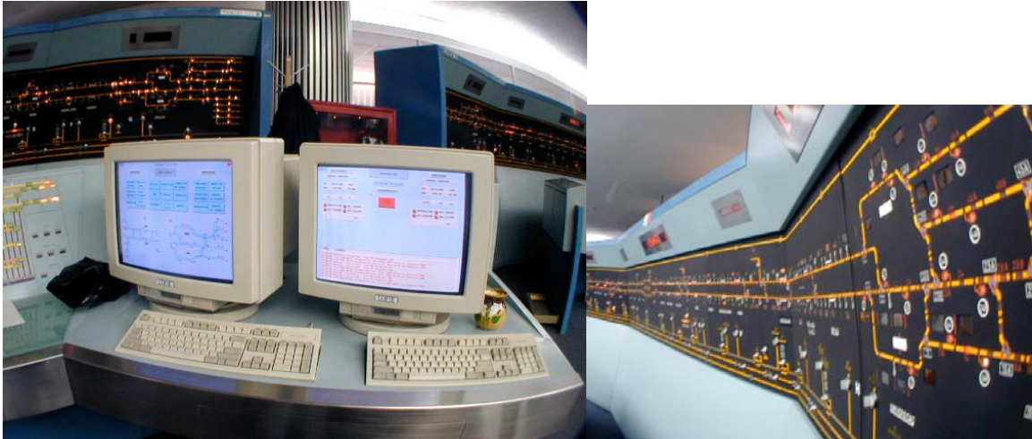
FIGURA VI.4 IMÁGENES DE MONITORES Y TABLEROS DE CONTROL DEL MANDO CENTRALIZADO
