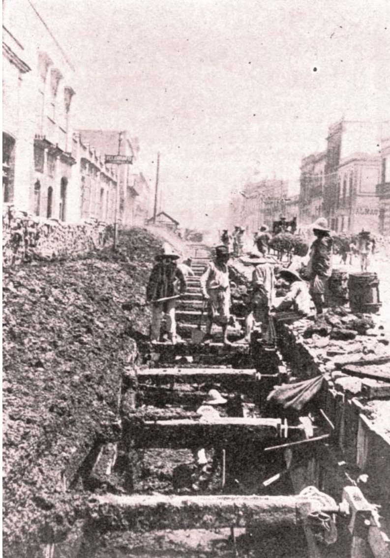
IMAGEN NO. 1.1.8 OBRAS DE DRENAJE EN LA CIUDAD DE MÉXICO.
