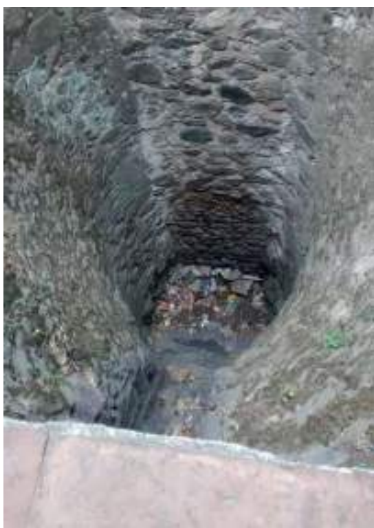
FOTOGRAFÍA 3.5. Conductos de aprovechamiento del agua contaminados. (2017) FUENTE: Elaboración propia.
