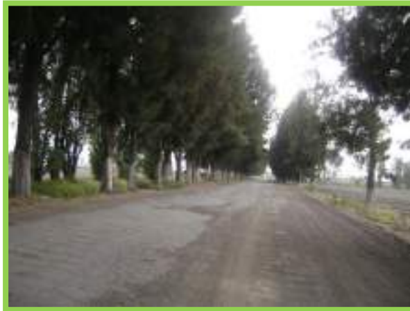
Fotografía 4.14 Calzada general (conocida como la del Toro, este camino rural comunica con las zonas de chinampas y con la Av. Tláhuac-Chalco)
