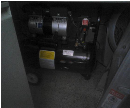
Figura 7-35. Sistema de aireación de los reactores. Compresor.
