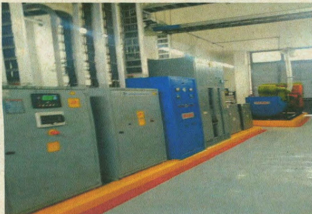
Casa de Máquinas donde se controlan todos los servicios del hospital.
