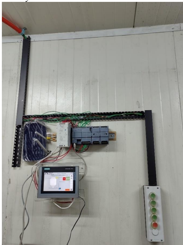
Figura 34 Conexión de PLC y HMI
