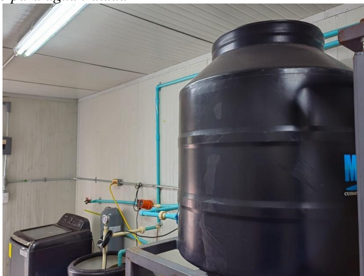
Figura 18 Tanque para agua tratada
