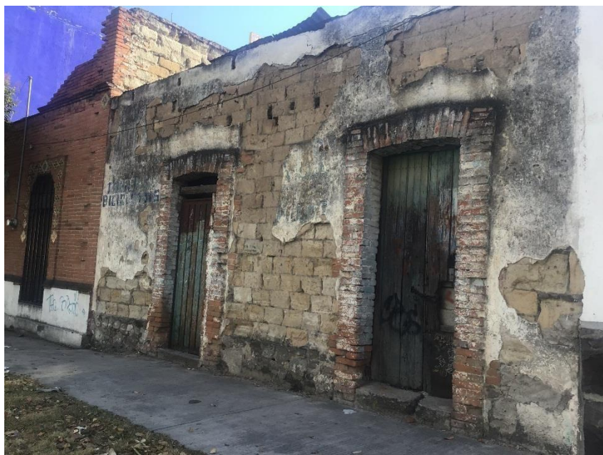
Fotografía 6. Autoría propia. Sin título. 2020. Casa que se localiza en las primeras cuadras de la ciudad. Se observa el deterioro a pesar de los intentos por restaurarla. En ella se observan los bloques de adobe y los marcos en las puertas hechos de ladrillo. A su lado se puede apreciar una construcción del mismo estilo y época, pero restaurada.
