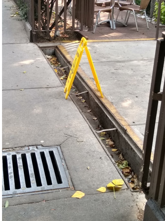
Ilustración 10: Obstrucción del espacio urbano.
