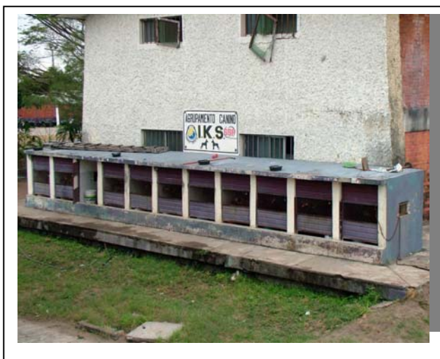
Instalaciones antes del cambio
