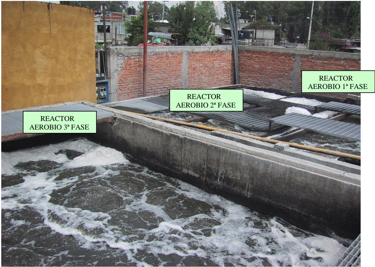
Figura 3.2 Presencia de espumas blancas en los reactores aerobios.
