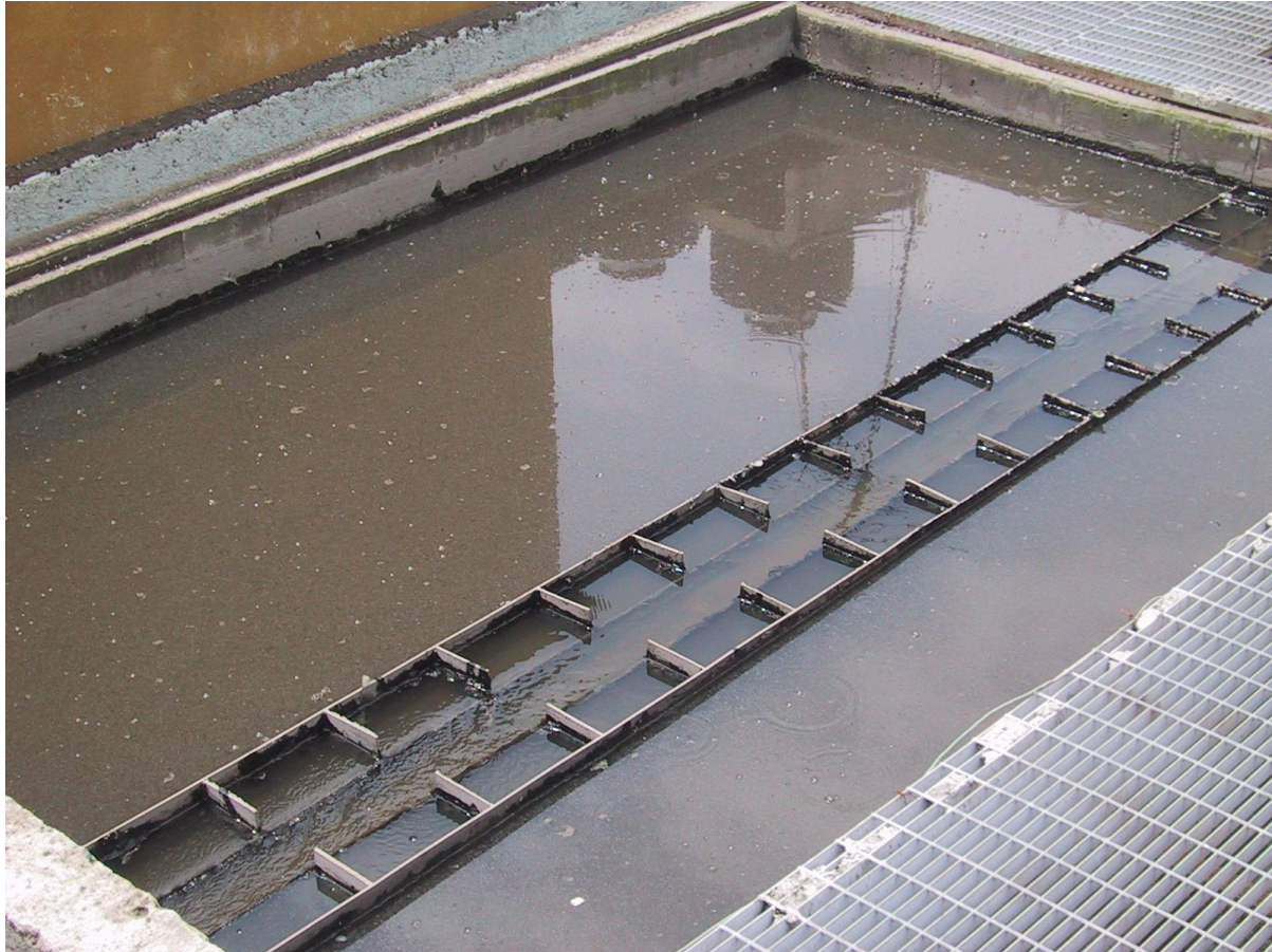
Figura 4.3 Sedimentador secundario con su desnatador
