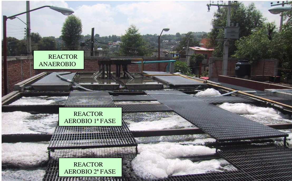
Figura 3.1 Presencia de espumas blancas en los reactores aerobios.
