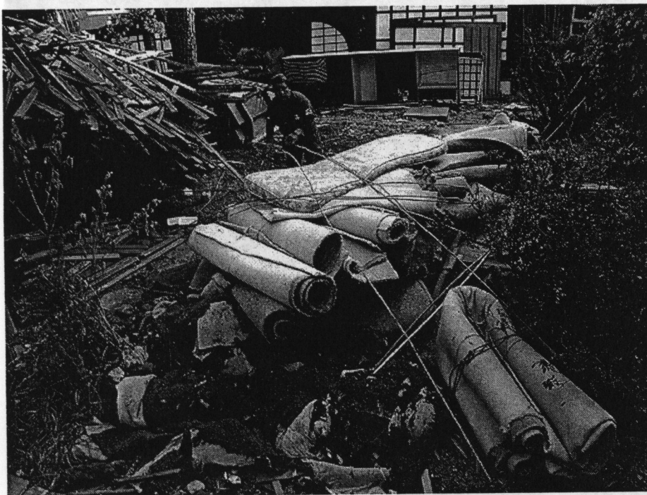
Muebles desmontados. Demolición de la casa de Checa #18, Chimalistac, DF. Antonio Ziri6n. 19 de enero de 2006.
