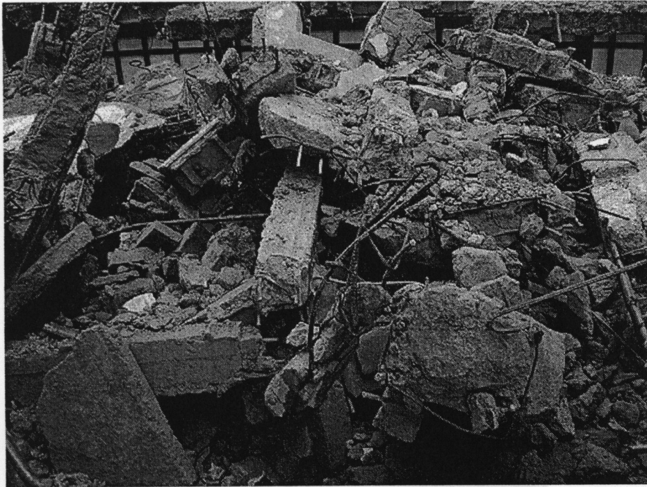
Escombros 4. Demolición de la casa de Checa #18, Chimalistac, DF. Antonio Zirión. 23 de enero de 2006.
