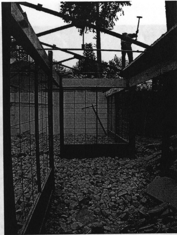
Demoledor sobre la estructura de la casa de Checa #18 en proceso de demolición. Chimalistac, DF. Antonio Zirión. 25 de enero de 2006.
