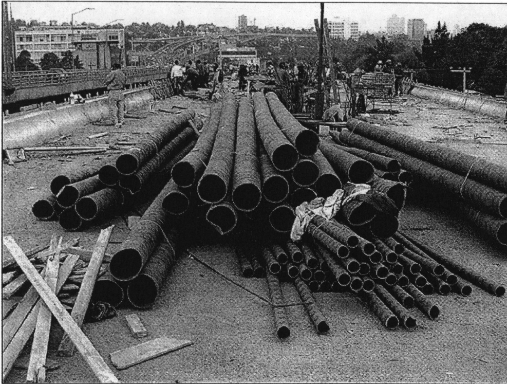
La obra del Segundo Piso del Periférico. San Ángel, DF. Antonio Ziri6n. 31 de enero de 2006.
