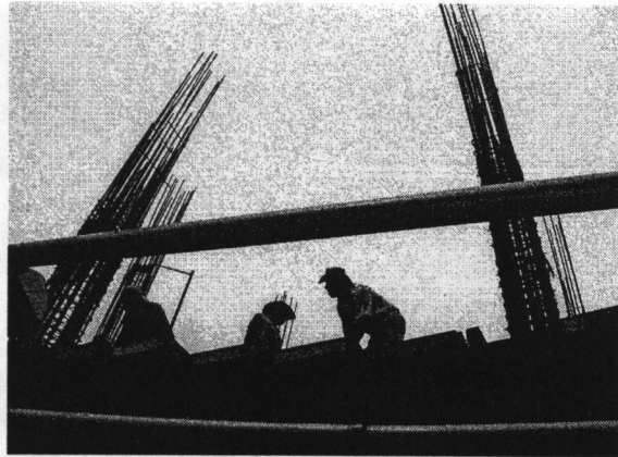
Castillos de varilla sobresalen de una construcción en la calle Dinamarca, Zona Rosa, DF. Antonio Ziri3n. 3 de julio de 2003.
