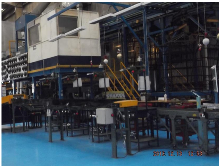
Fotografía No. 12. Cabina de pintura automatizada (arriba). Segunda banda transportadora y línea de inspección de pintura (abajo) (Área de pintura, unidad de metal).
