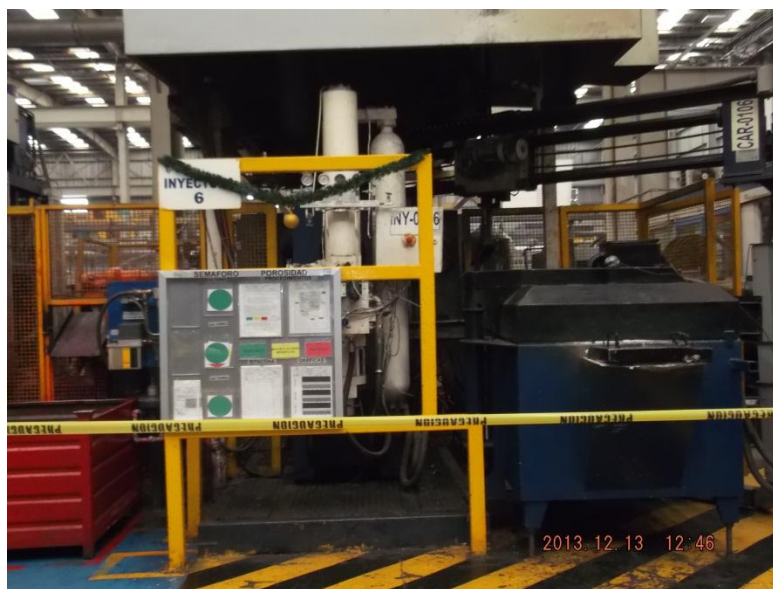
Fotografía No 2. Máquina inyectora de aluminio (área de inyección, unidad de aluminio)
