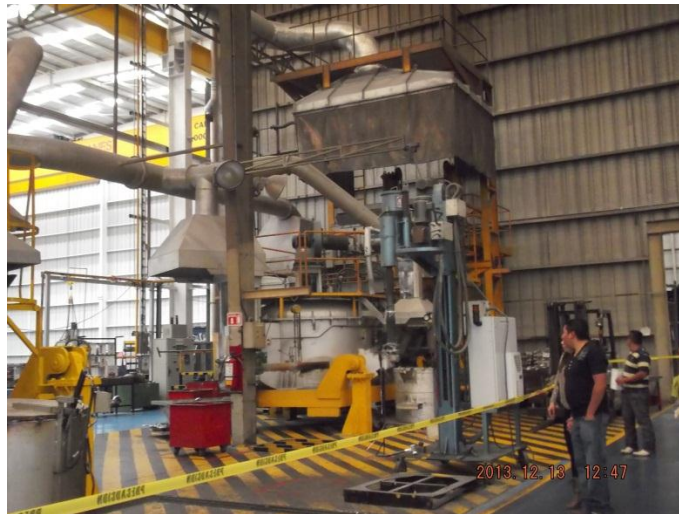
Fotografía No1. Horno o torre fusora (área de inyección, unidad de aluminio)
